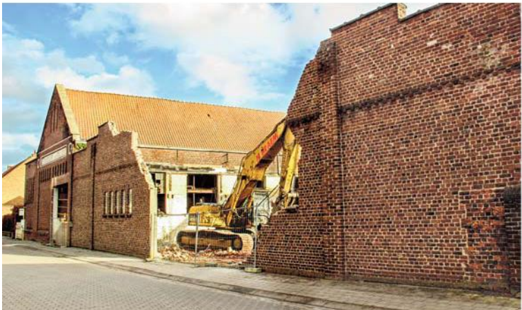
Het fabriekspand aan de overkant van de garage-fietsenhandel Vantomme stond al jarenlang leeg. Het begon er heel lang geleden met een distillerie van glycerine en olieslagerij. In de twee loodsen startte in 1951 het tabaksverwerkend bedrijf van Albert Ramon. (Foto MV)
